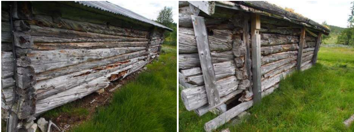
Figur 3.8. Det står noe dårlig til med enkelte stokker og vegger på Rånøyene; råte til venstre, fare for utsklidning til høyre.
