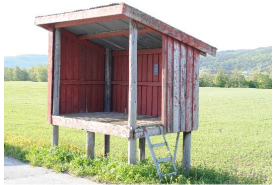
Melkerampa ved Hoem, ved krysset mot Kulsetbrua. Her er det tydelig vedlikeholdsbehov.
