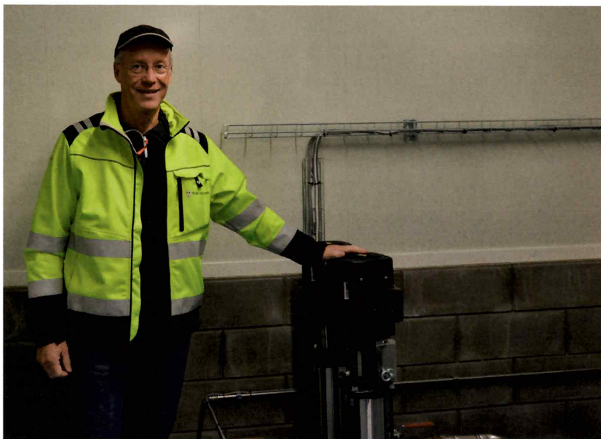
Selbu kommune har fått fire nye høydebasseng de siste 4 årene – og alle anleggene har svart til forventningene. Det største bassenget kan gi kommunens innbyggere vannforsyning i ett døgn ved krisesituasjon. Foto: Kjell M. Jacobsen
